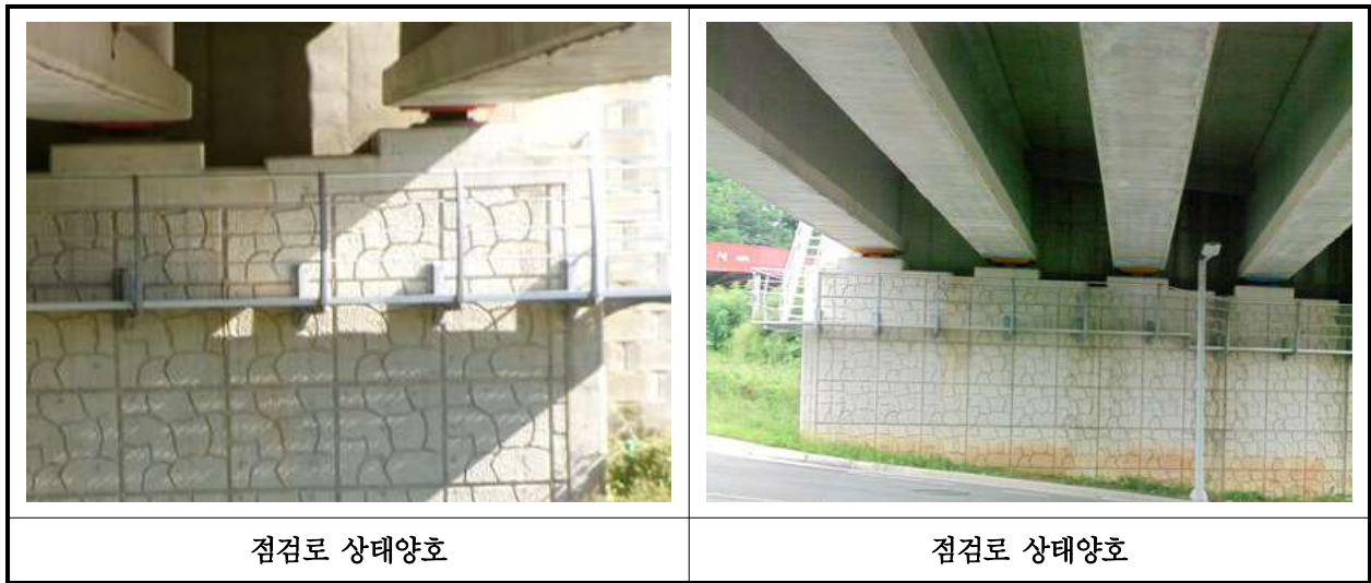
【사진 29.3.23】 교량 점검시설 손상현황
