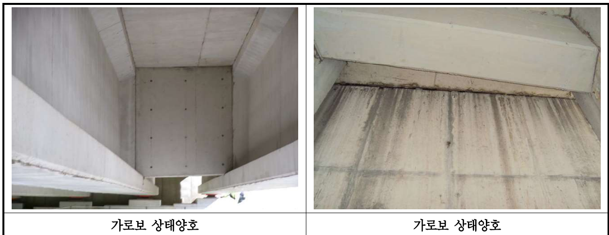
【사진 29.3.7】 가로보 손상현황
